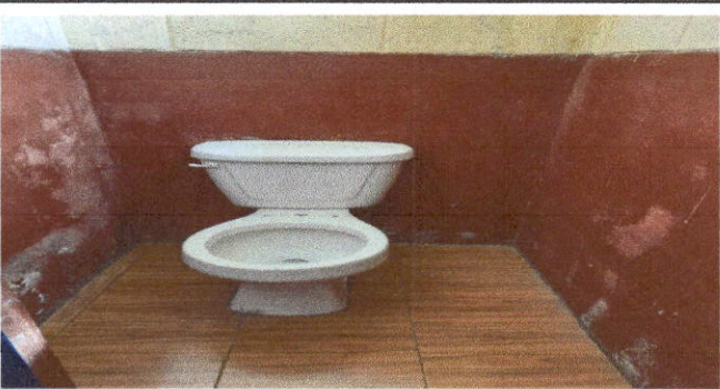
Foto 15: Sustitución de accesorios para descarga de agua en inodoro, en area de sanitarios de hombres y mujeres.
