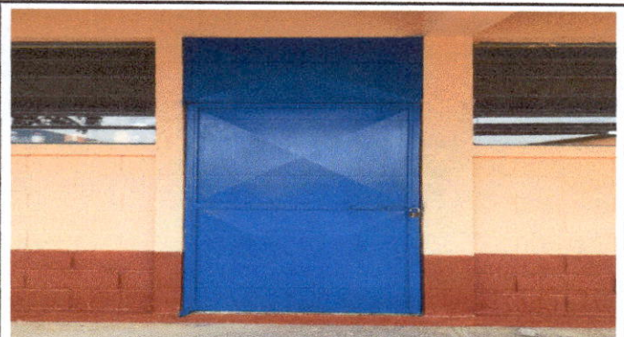
Foto 8: Puertas. Mantenimiento a estructura (lijado, cepillado, aplicación de pintura). En aulas, sanitarios y dirección del modulo 2 (parte de arriba) del establecimiento.
